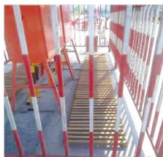
配电箱防护棚实景图
